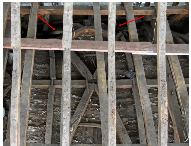
Abb. 3 Draufsicht der Gewölbekonstruktion, rot markiert: gut zu erkennen die Busung (Bauchung) der Gewölbekappen
